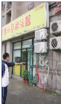
离地面较近的空调外机被盗了
