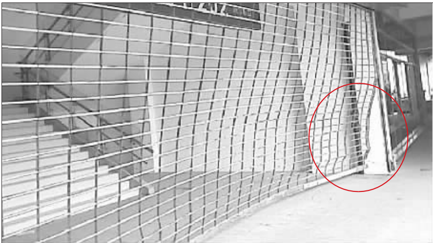
通道处的卷帘门发生严重变形
