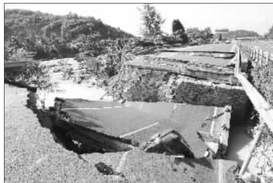
3月28日拍摄的事故现场 新华社发(蒙钟德 摄)
