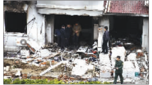
事故现场两栋居民楼部分住户门窗不同程度受损。新华社记者 裴鑫 摄
