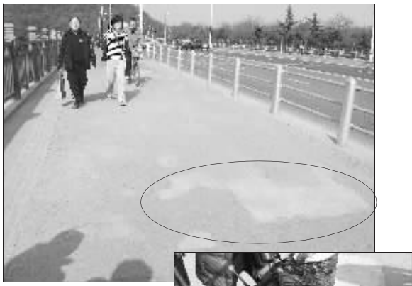
▲▲破损的路面随处可见
