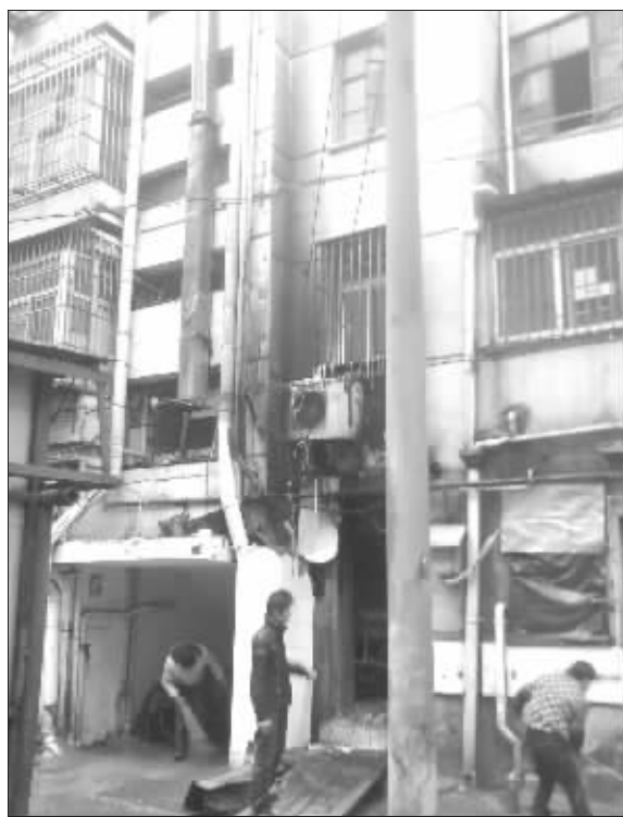
居民楼外墙被烧黑一大片 快报记者 王冕 摄
