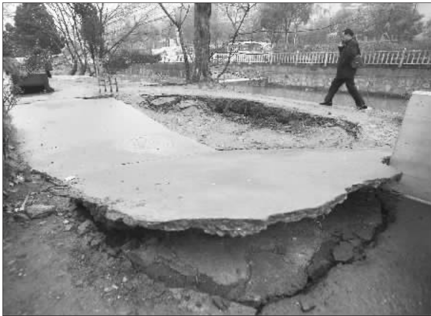
塌陷的地面,影响路人的通行。快报记者 泱波 摄
