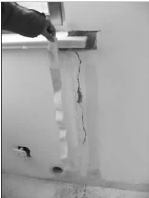
市民揭下遮盖裂缝的胶条
