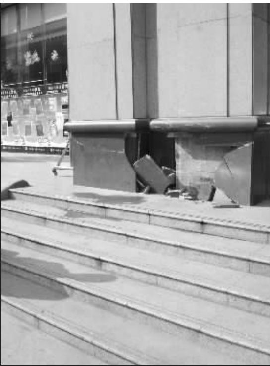
被轿车撞碎的墙壁
