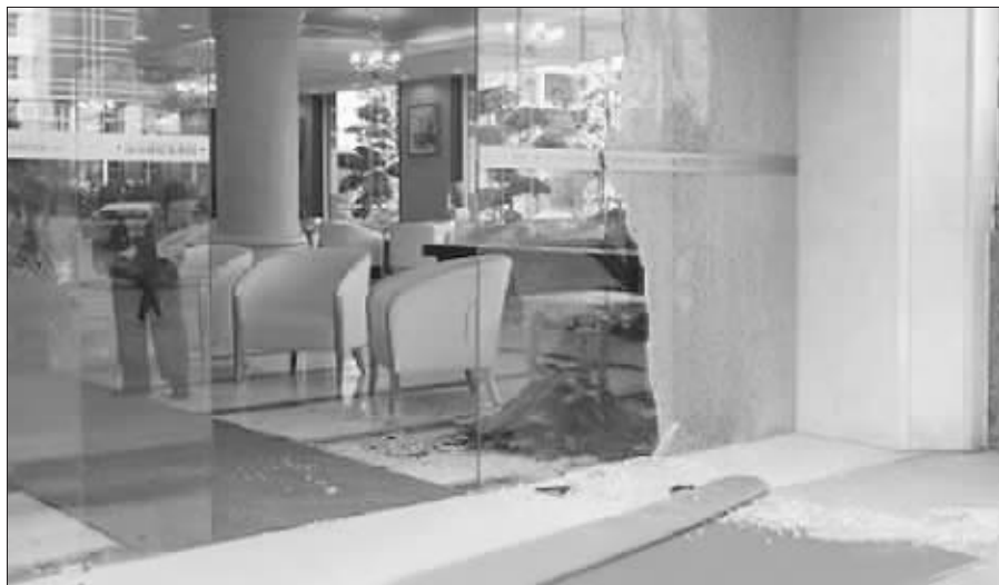
冲突中雅居乐售楼处玻璃门受损
