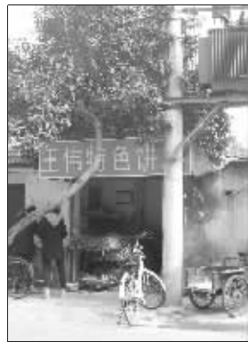
这棵树傍上高压变压器
