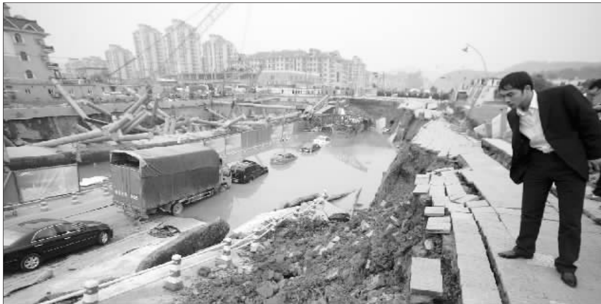
杭州地铁施工工地发生塌陷,一些行进中的汽车坠入塌陷处。 吴煌/CFP
