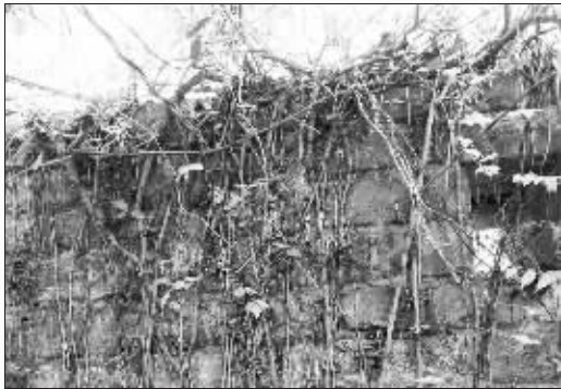
它们让明城墙城砖松动、断裂 快报记者 赵杰 摄
