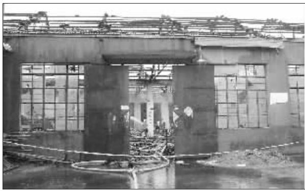
厂房已被烧成“骨架”
