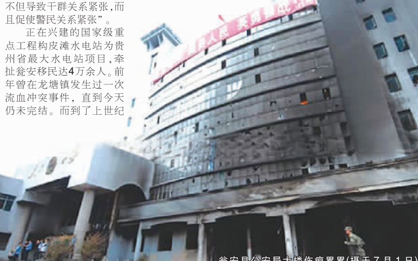
瓮安县公安局大楼伤痕累累(摄于7月1日)
