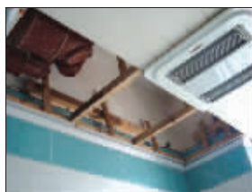
卫生间墙顶发霉
