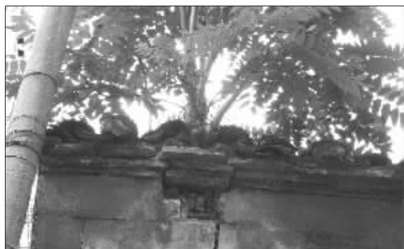
屋顶上这棵树长得挺茂盛,墙体都被撑裂开了
