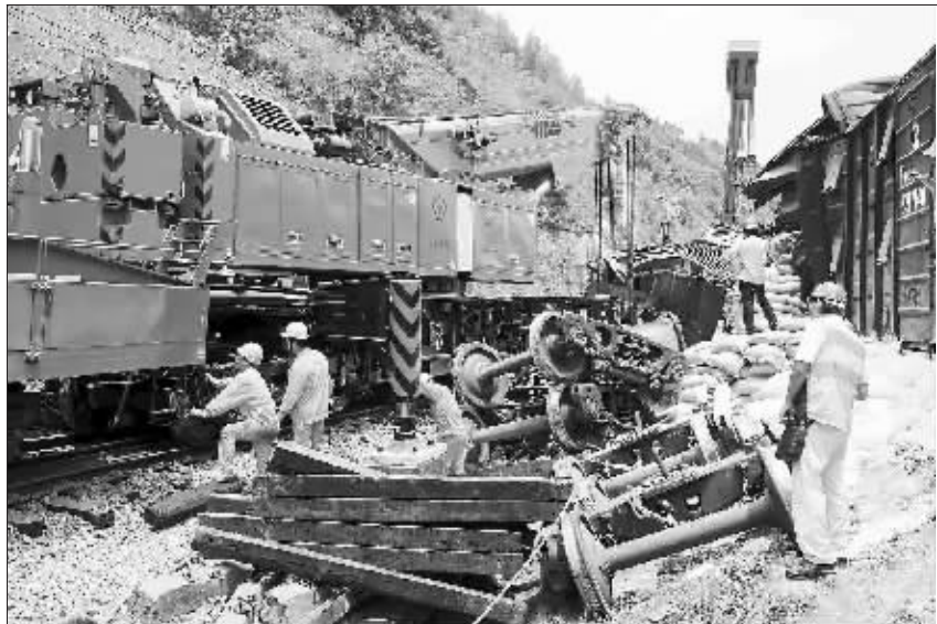
6月8日,铁路抢修队伍在达成铁路上对脱轨列车进行救援 新华社记者 陈凯 摄
