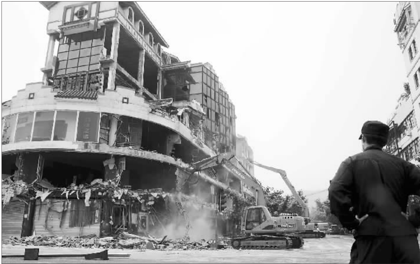
抗震救援队伍正组织重型机械在都江堰市区清理遭受地震损毁的房屋。新华社记者 陈凯摄
