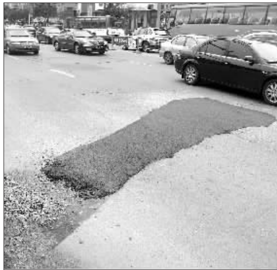
洪武北路上,到处坑坑洼洼 快报记者 顾炜 摄
