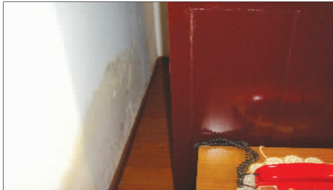
墙面渗水发霉严重
