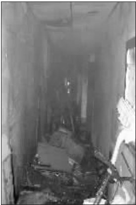
楼道被烧得一塌糊涂
