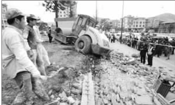
现场坍塌的砖墙仍未清理
