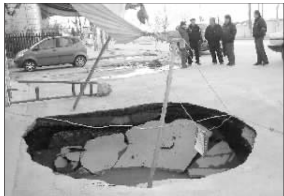
塌陷路面约六七平米 快报记者 顾元森 摄
