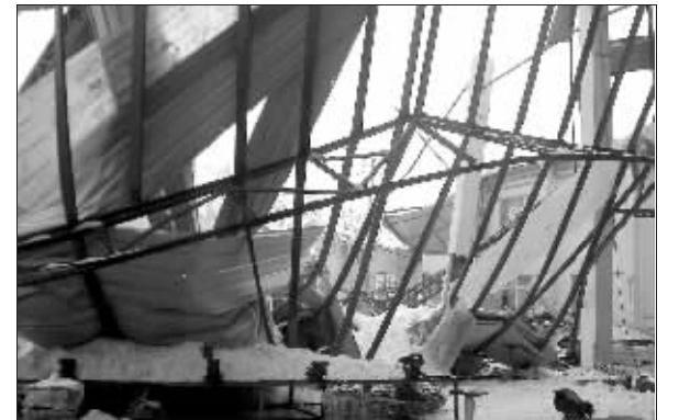
26日夜里倒塌的厂房 快报记者 孙玉春 摄
