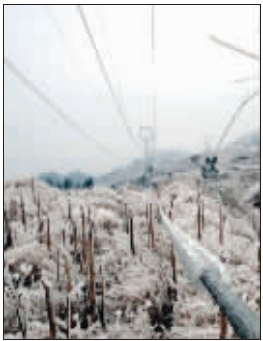
26日,贵州都(匀)麻(尾)220千伏线路的一相线路被覆冰压断。 新华社记者 杨巍 摄
