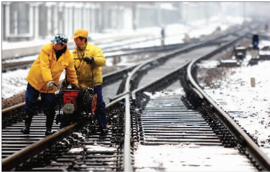
铁路护养员正在南京火车站进出站的岔道口巡视 快报记者 顾炜 摄
