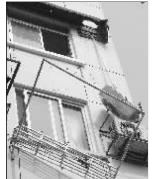
“肇事”空调外机已脱落 快报记者薛林摄
