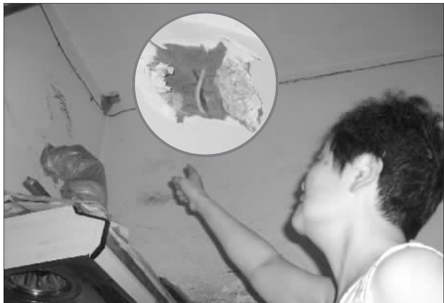
厨房墙角被雷炸出洞,电线裸露出来
