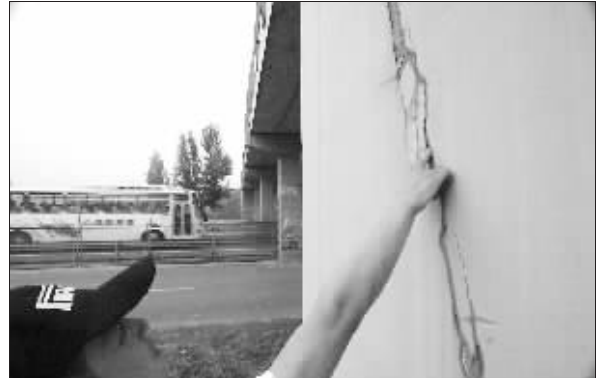
桥墩上的裂缝
