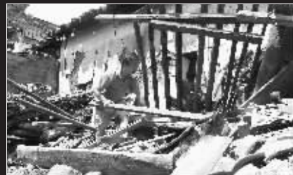
居民在清理自家倒塌的房屋
