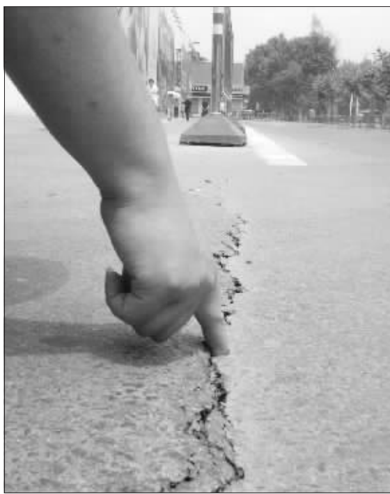
路面上的裂缝连手指都能伸进去
