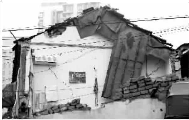
民居被大水冲塌。
