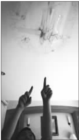
业主的卧室房顶还严重漏水
