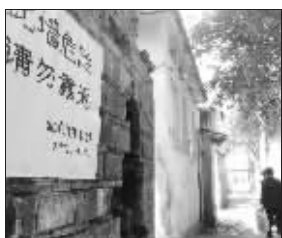
墙体开裂程度惊人
