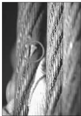
电梯钢丝绳磨损严重
