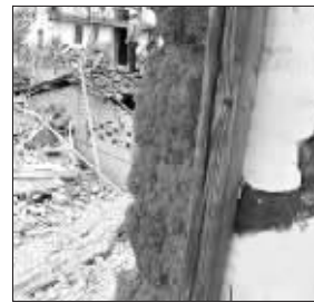
墙壁都出现了裂缝
