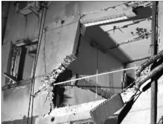
发生爆炸的302室。
