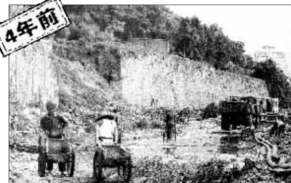
2003年维修时留下一段坍塌的城墙没修 (资料图片)
