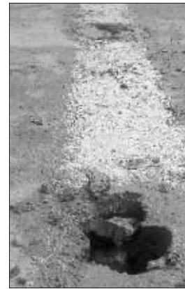
隔离桩被拔留下的洞
