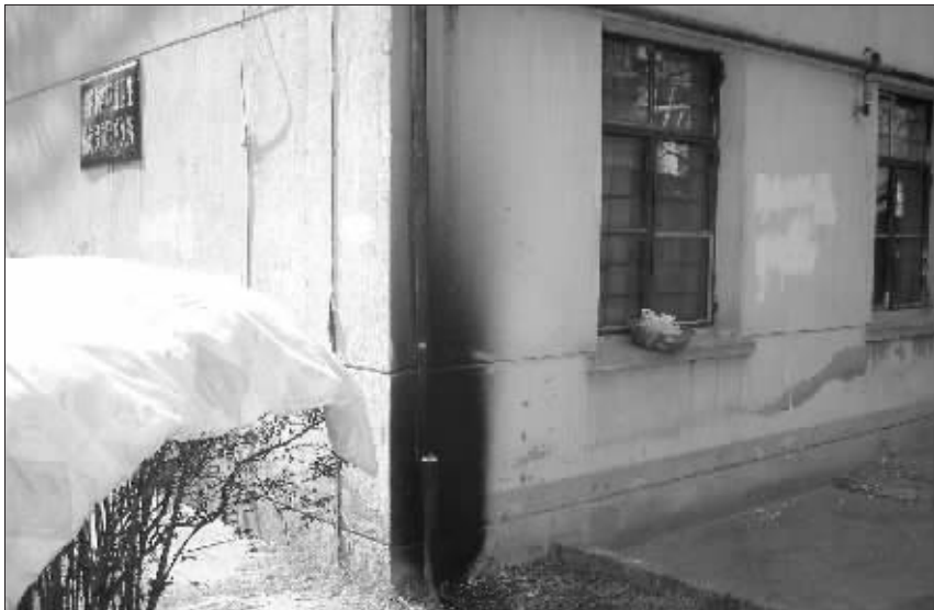
煤气管道上,有一段被熏得乌黑
