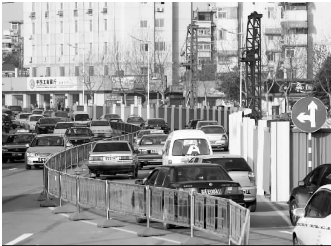
昨天,南京新模范马路隧道工程南京邮电学院路段围挡结束,预计今天开始施工。 快报记者 翁叶俊 摄
