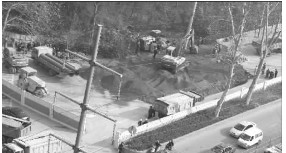
前晚,小卫街发生路面塌陷,昨天,工人们还在对塌陷的路面进行填埋
