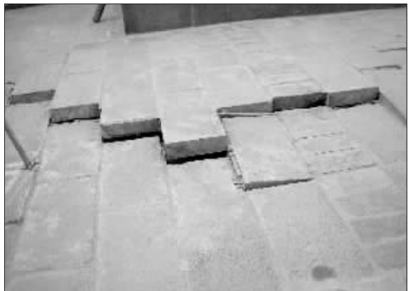
小区东门口地面下沉开裂
