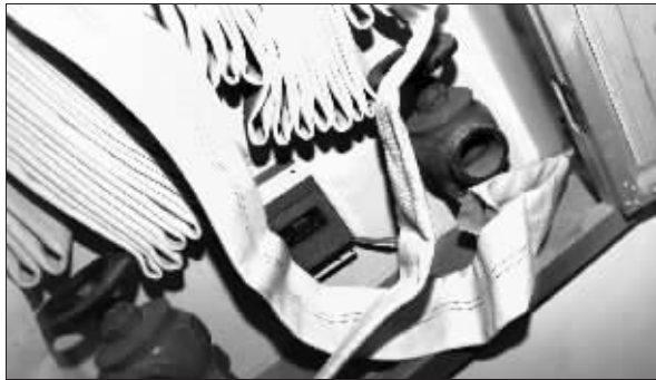
消防栓和消防设备都是坏的 快报记者 施向辉 摄
