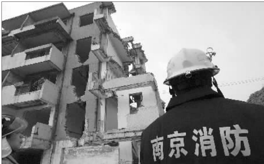
两民工被埋,消防队员立即赶到现场营救
