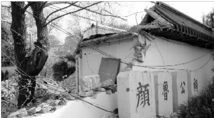
颜鲁公祠围墙及石碑被砸现场一片狼藉
