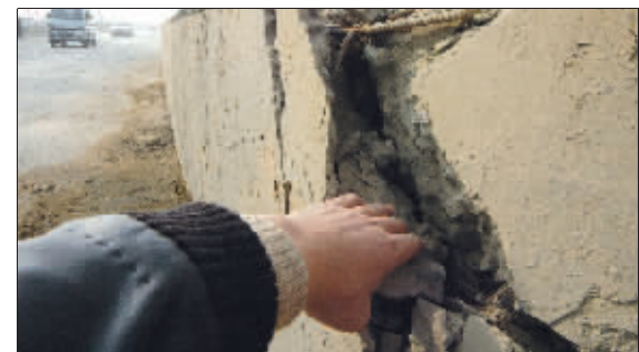
护墙被撞出一条大裂缝 快报记者 薛林 摄
