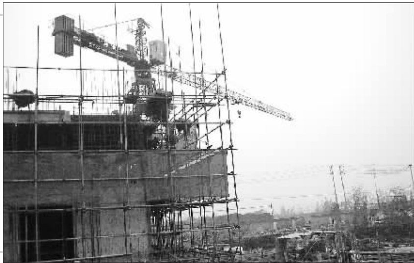
事故发生后,这个塔吊已被停止作业 快报记者 陆鸣 摄
