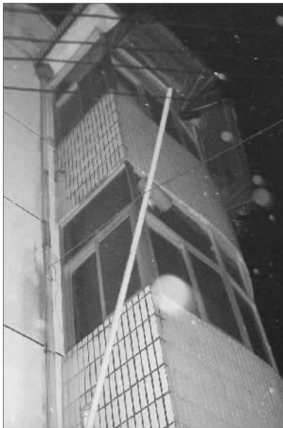
楼房外墙的水管断了
